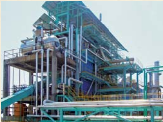
インドネシアRPI社の木質バイオマスボイラー
